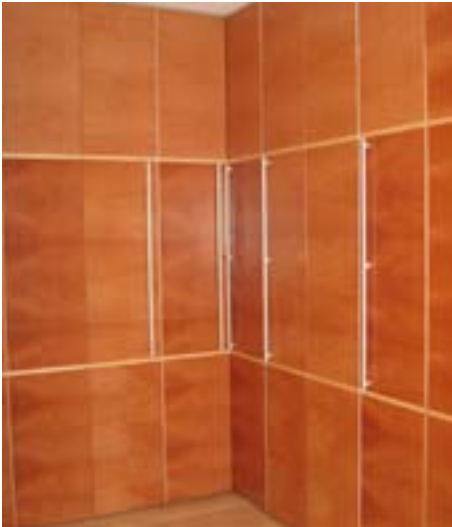
Vgradna omara v spalnici (2009)
