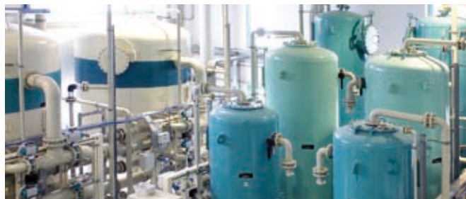
Priprava vode, TE Brestanica, 2000
