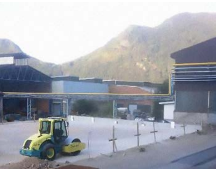
Gradnja ranžirnega skladiščnega platoja za plansko paletno oskrbo plošč za obdelavo v PDP
