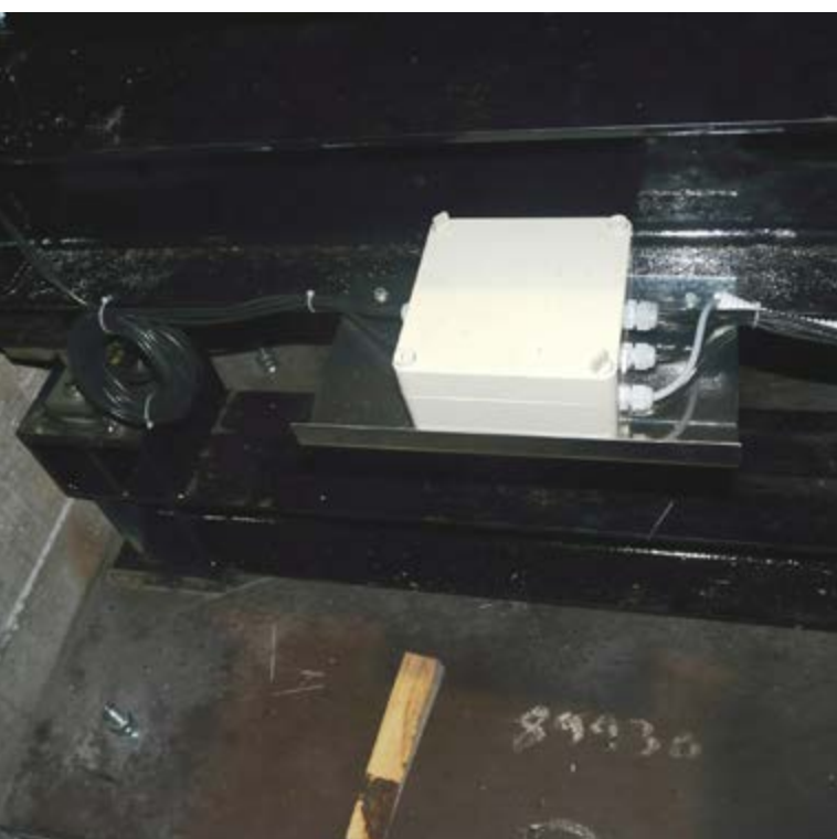
Na fotografiji je povezovalna omarica za merilne celice, spodaj pa se lepo vidi sidrana nosilna plošča za merilne celice.
