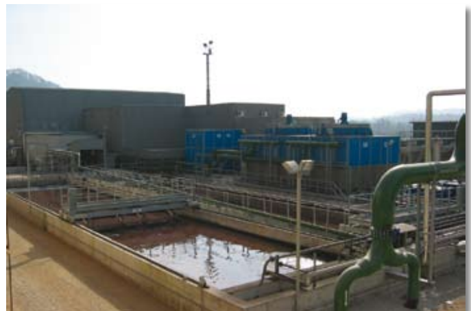
Vzdolžni bistrilniki umazane vode, v ozadju so hladilniki vode
