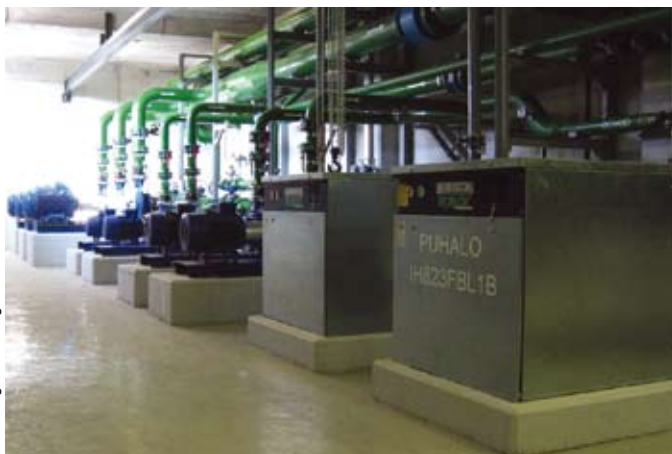
Dobavne črpalke čiste vode
